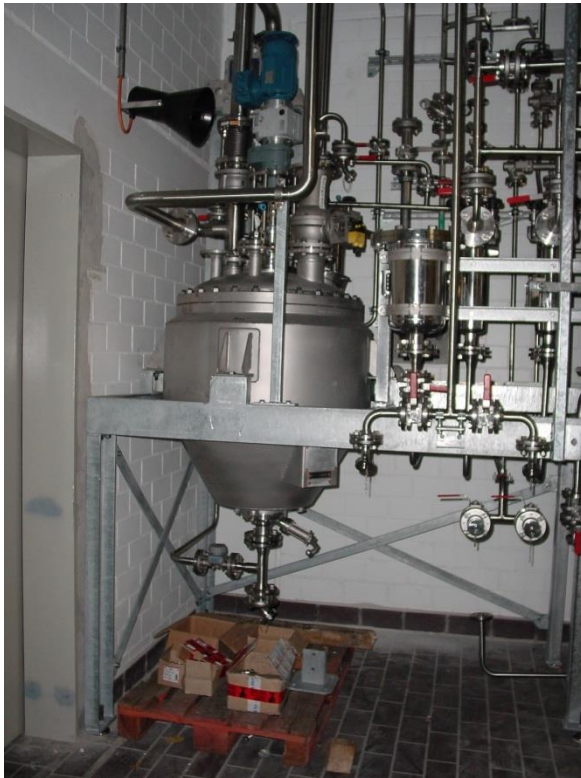
Rührbehälter 160L Mixing Vessel 160L
