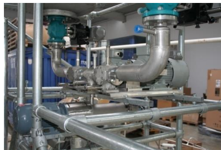
Dosierpumpen/ Dosing pumps
