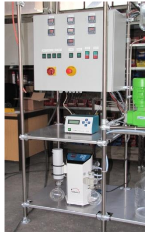
Schaltschrank ... Electrical panel
