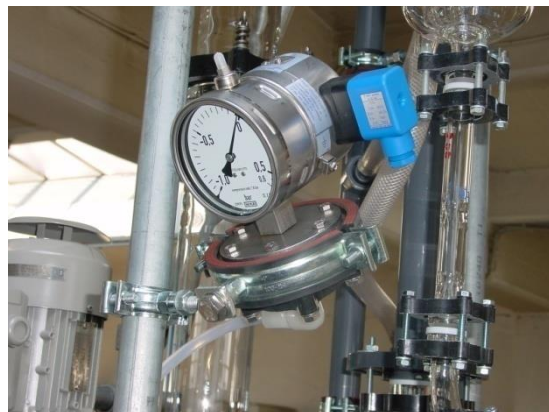
Druck Messung / Pressure gauge
