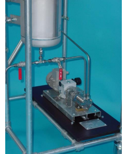
Dosierpumpe / Dosing pump
