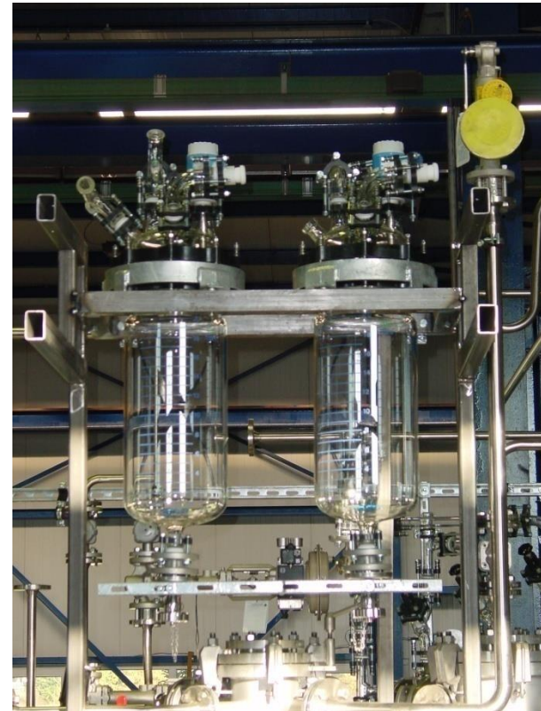
Dosiervorlagen / Dosing Tank
