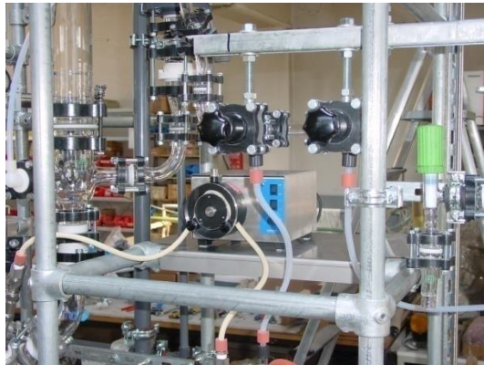
Dosierpumpe / Dosing pump
